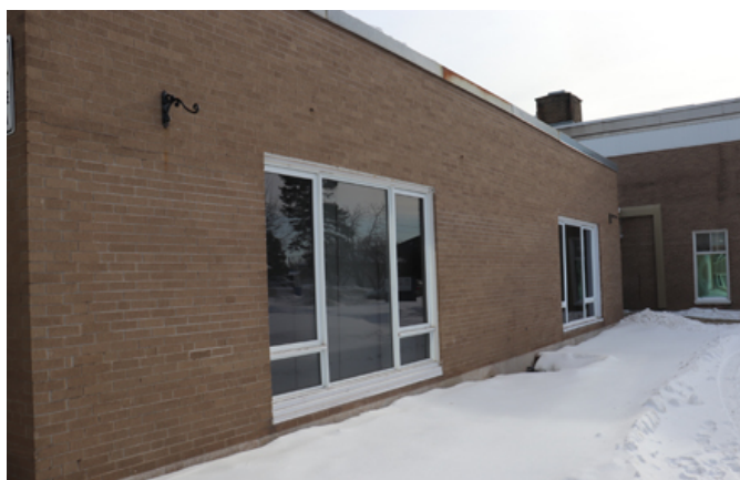
90. Sur la façade avant, une nouvelle fenêtre a été ajoutée (à droite) à celle qui existait déjà à l'origine (à gauche).
