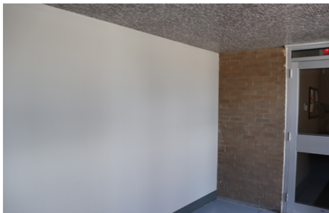
88. L'ancienne entrée de la bibliothèque a été entièrement murée.
