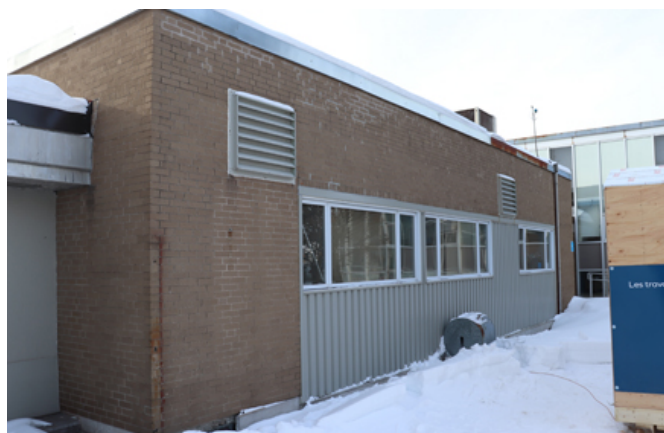
91. À l'arrière, les fenêtres qui descendaient à l'origine jusqu'au sol ont été rétrécies et le mur a été comblé par un revêtement de tôle profilée.
