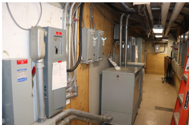
95. Salle électrique au sous-sol de l'ancienne bibliothèque municipale.
