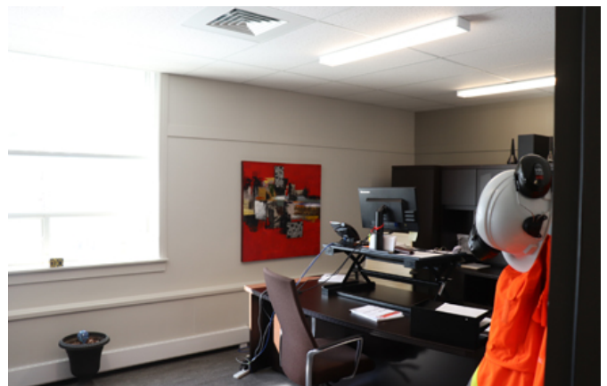
102. Espace de bureau aménagé à l'étage de l'ancien poste de police et d'incendie. Une nouvelle fenêtre a été percée.
